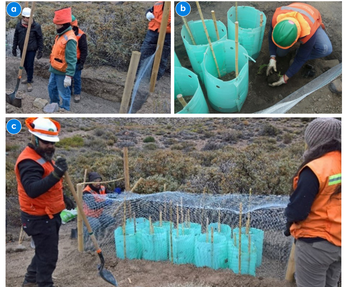
Figura 14. a) Excavación del núcleo e instalación de la malla al fondo. La sección de malla instalada al fondo sobresale hacia arriba 1 metro para facilidad de cierre perimetral; b) distribución de las plantas en las casillas e instalación del tree shelter para cada una; c) núcleo protegido en pleno nivelado y terminado.
